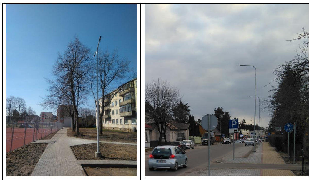
6 pav. Modernizuotas apšvietimas Varėnos mieste
