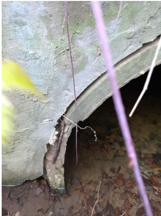
12 pav. Pralaidos pažeistas vamzdis
