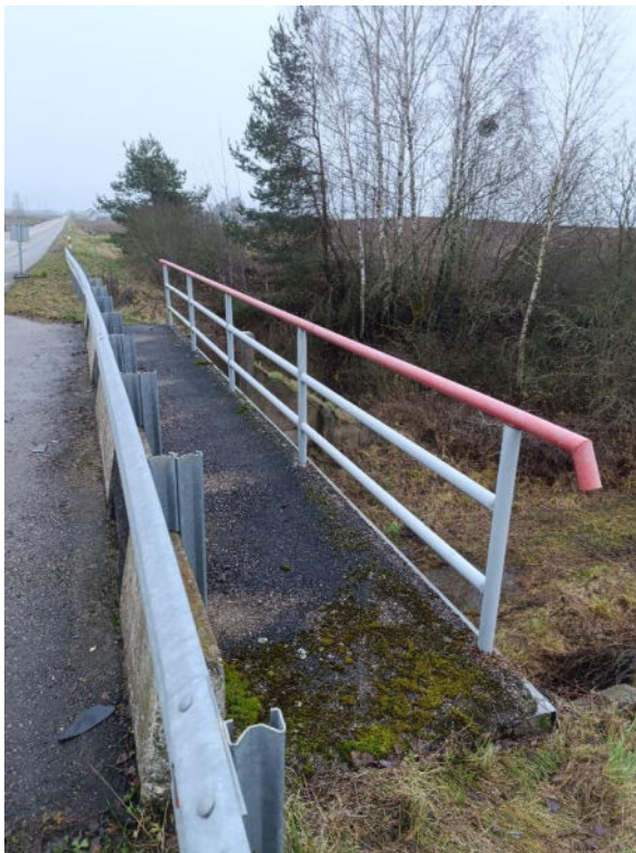
2 pav. Metaliniai tilto turėklai pažeisti korozijos
