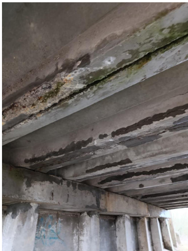
6 pav. Nesandarus hidroizoliacijos sluoksnis
