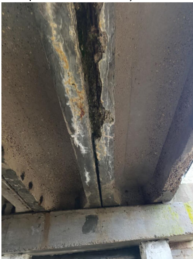
7 pav. Pažeistos viaduko perdangos sijos
