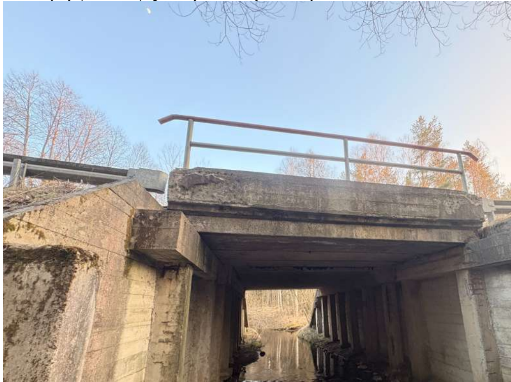
5 pav. Tilto fasadas, surūdiję turėklai ir pažeidimai betono konstrukcijoje
