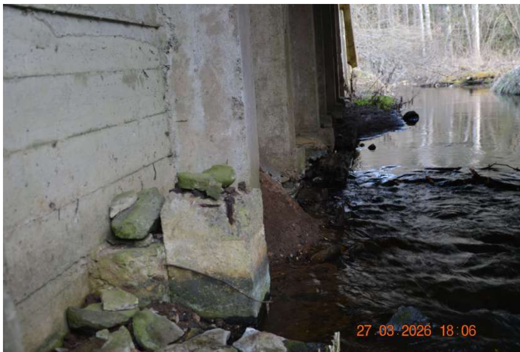
10 pav. Polių defektai, atšokęs apsauginis betono sluoksnis
