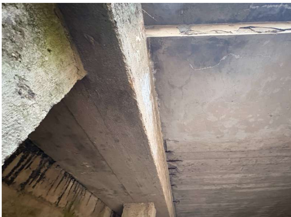
7 pav. Pažeidimai perdangos plokštėse
